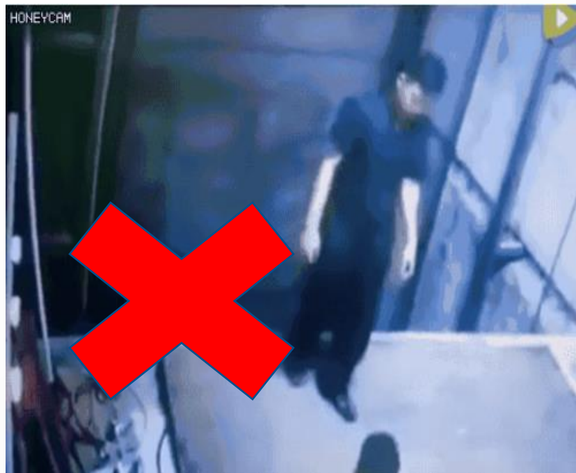
电梯井洞口未防护
