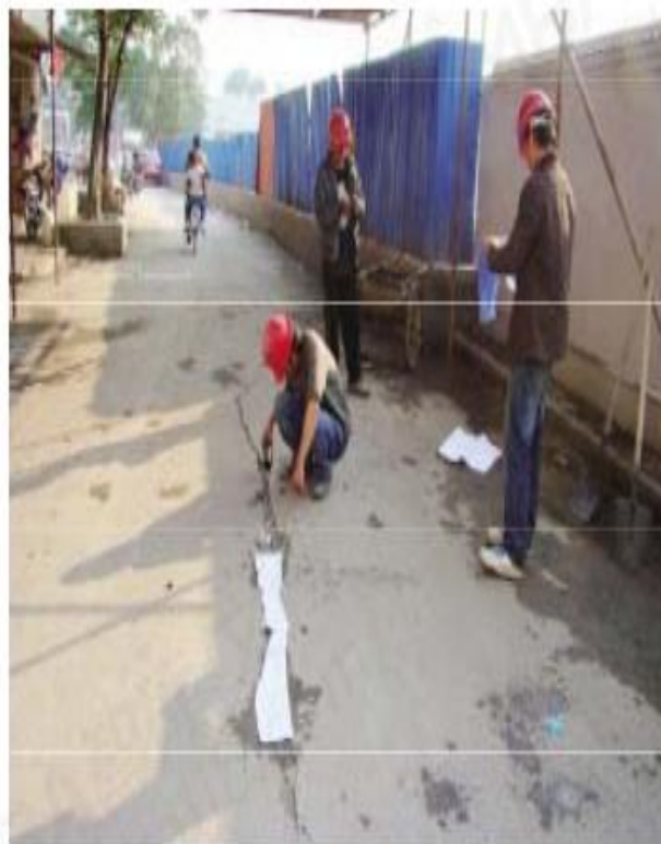
2010年1月南宁市中兴街路面开裂
