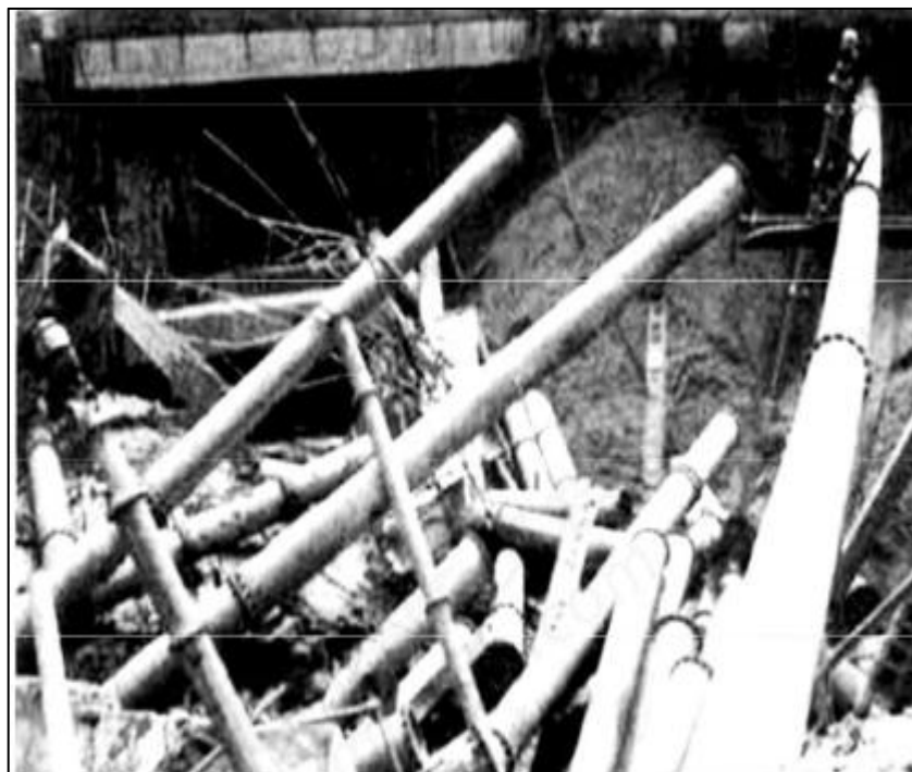
2009年杭州地铁1号线凤起路站基坑内土体滑坡及支撑体系破坏
