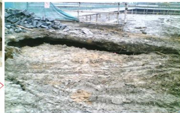
宁波某基坑发生流土与地面塌陷
