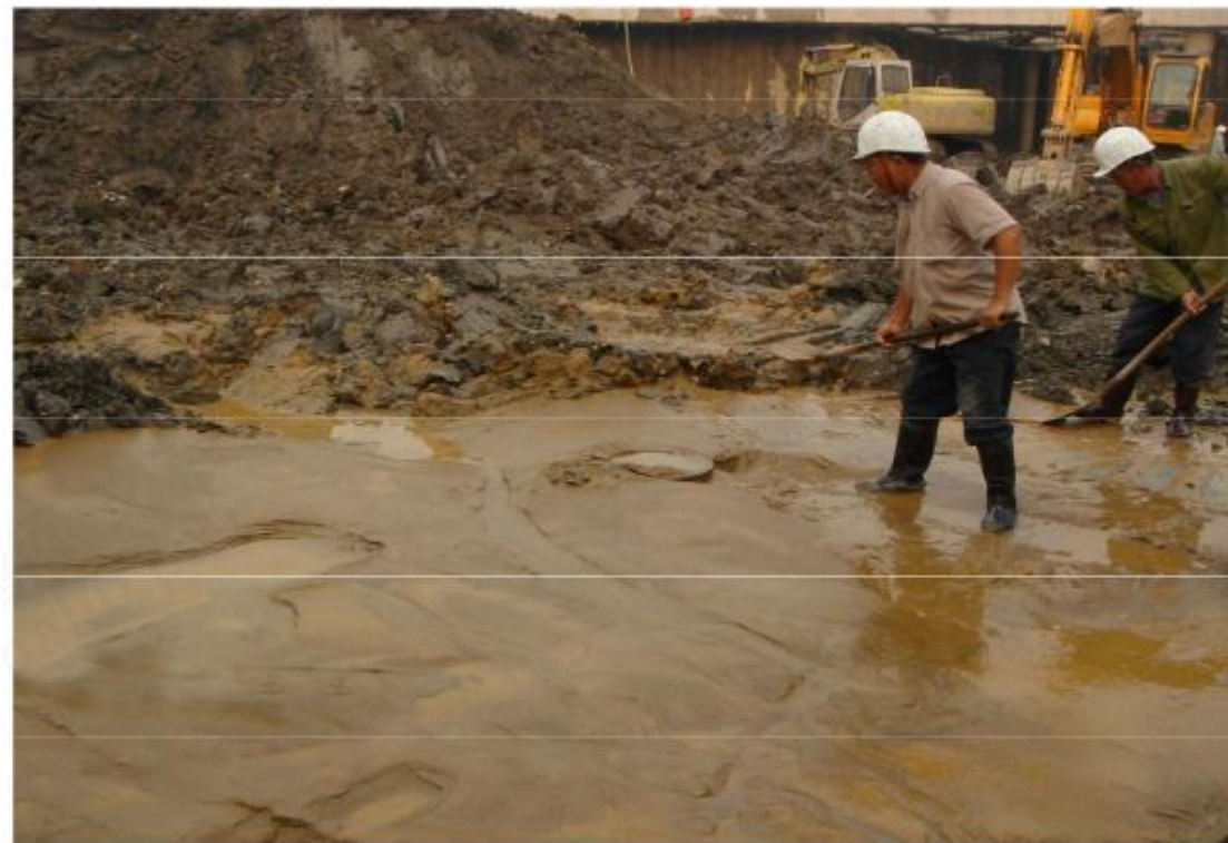
上海某基坑坑底内发生承压水突涌
