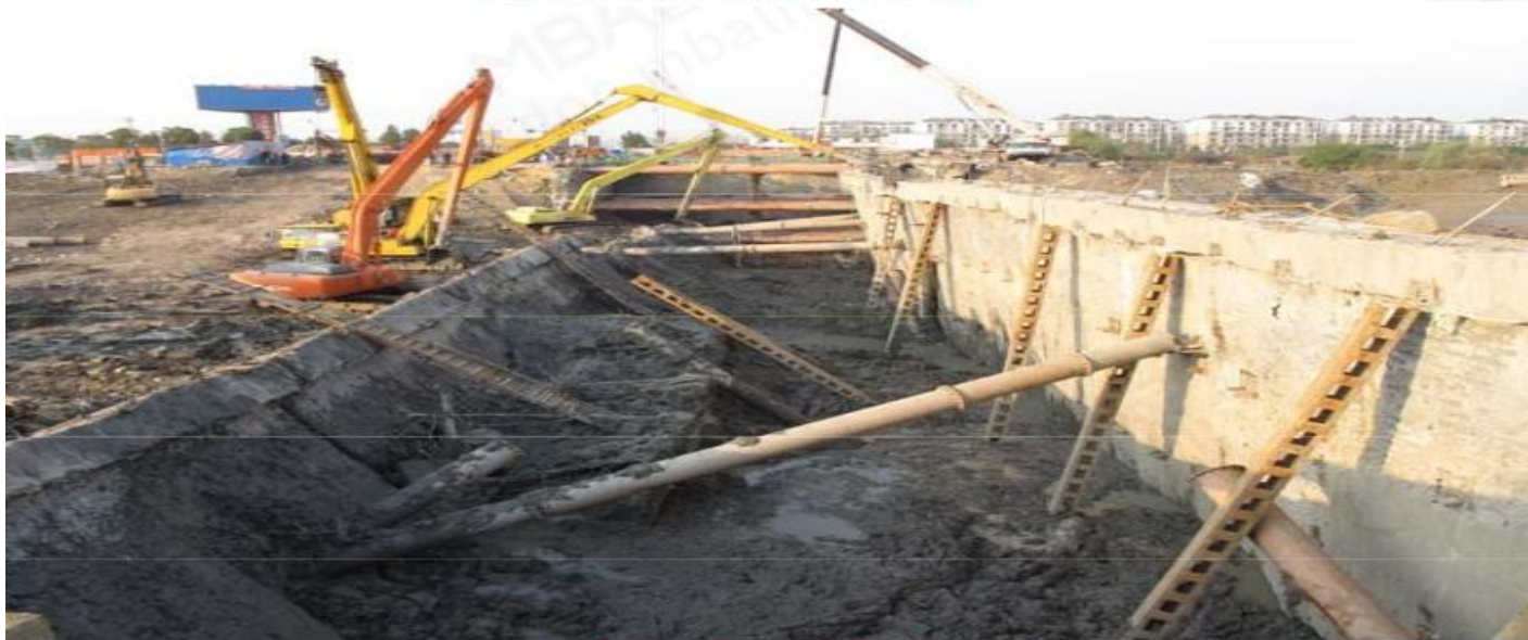
2008年杭州地铁地下连续墙折断破坏
